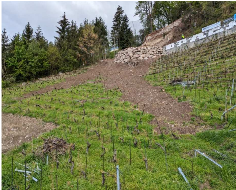
Avvallamento con distacco di rocce
